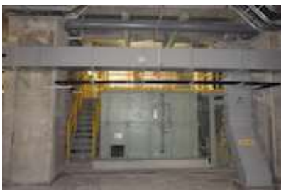
・原川水資源再生センター ・脱臭設備
