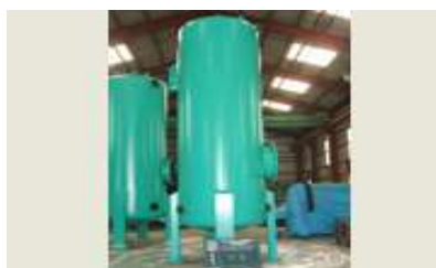
・猪名川上流ごみ処理施設 ろ過タンク
