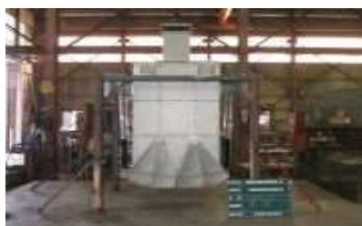
・浸出水処理施設 ・ケーキホッパー
