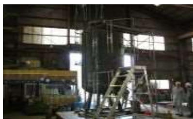
・化学工場向け ・除鉄タンク(SS)
