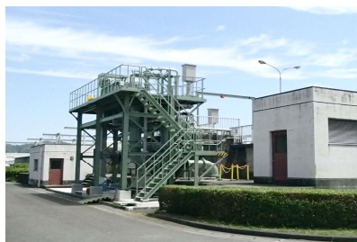
・臼杵終末処理場 ・沈砂池設備
