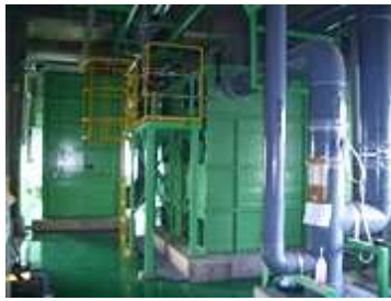
プラント設備
