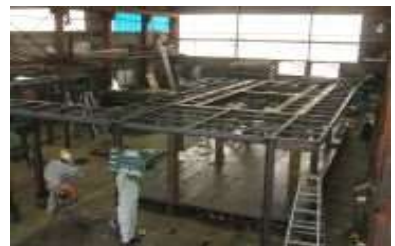
・汚泥濃縮機架台
