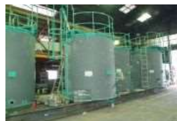
・御笠川浄化センター ・廃油タンク Φ2400×3500H
