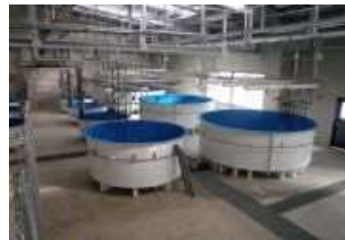
・水産試験場種苗施設 ・給排水設備
